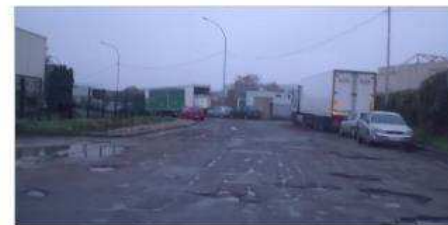
Chaussée dégradée Rue du Travy
